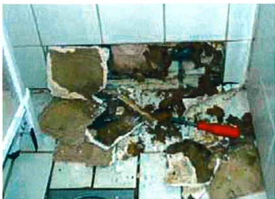
Feil materialbruk kan gi store skader på våtrom
